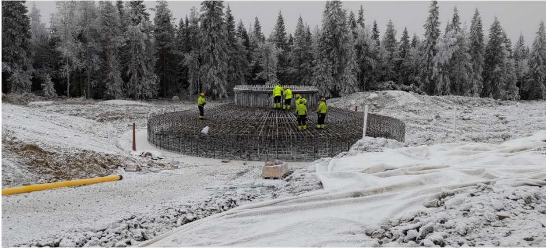
Figur 8. Gravitationsfundament innan gjutning i en av Fred. Olsens vindparker. Foto: Fred. Olsen Renewables AB.
