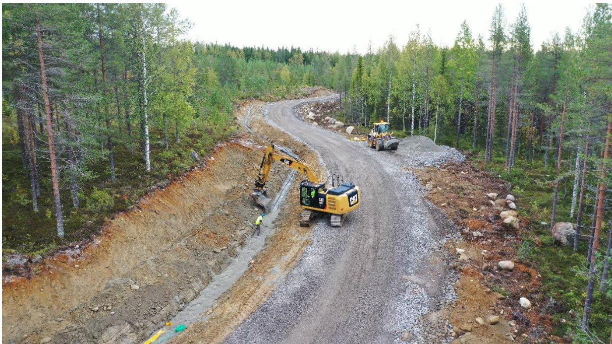
Figur 14. Kabelgrav med kabel och kommunikationsnät intill väg. Foto: Fred. Olsen Renewables AB.
