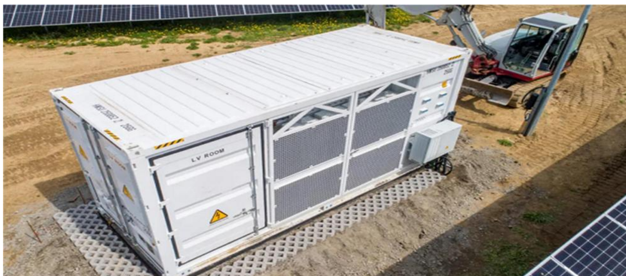
Figur 38 Stasjonære mellomtransformatorer innebygd i std containere.
