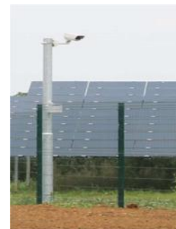
Figur 65 Overvåkningsanlegg har flere formål i en solpark
